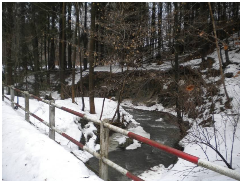
Foto 2: Porušené koryto vodoteče Zašovský potok v ř. km cca 4,8
