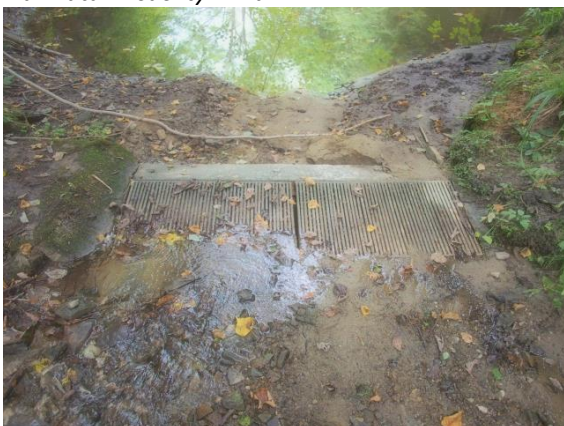
Odběrný žlab s roštěm na vtoku
